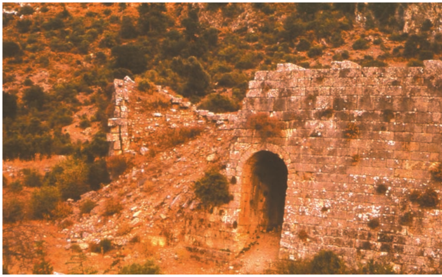
Tiyatro çevre duvarı üzerindeki göçük, 1966 yılı
