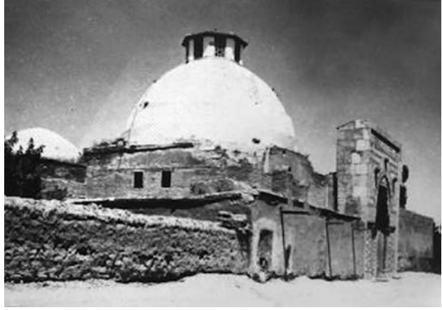
Konya-Karatay Medresesi'nin 1914 yılında çekilen fotoğrafından anlaşıldığı gibi duvarlar ve kubbe çürümüş, çürüme ve tahribat devam ediyordu.
